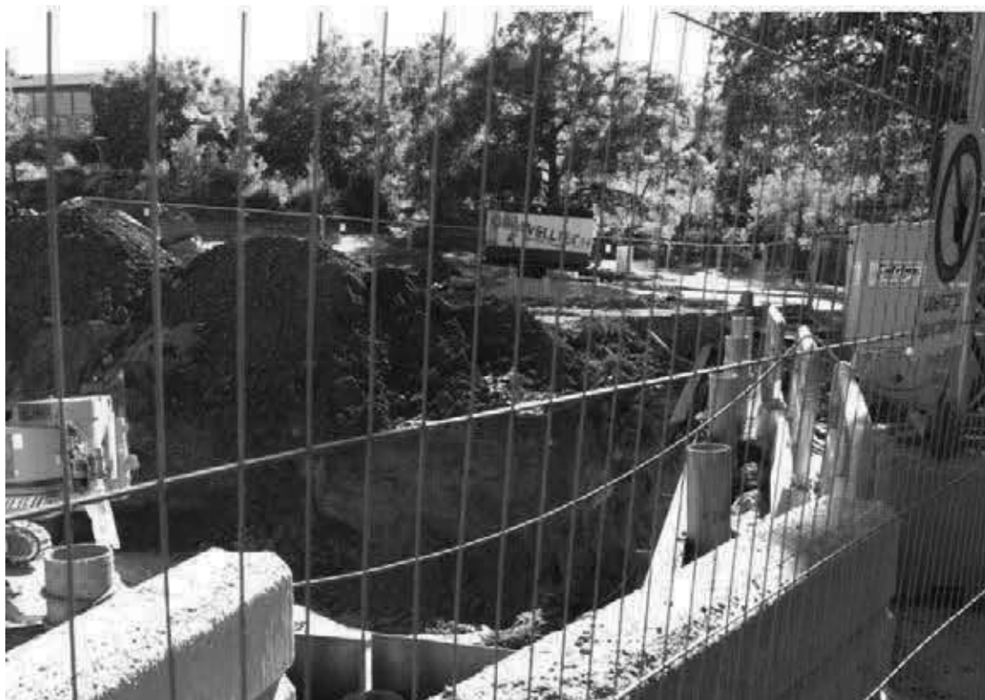
Fig. 2. Vertikala schaktslänter. Trånga utrymmen gör det svårt att schakta med erforderlig slänthlutning men det är just sådana problem som man ska lösa i planeringsskedet.
