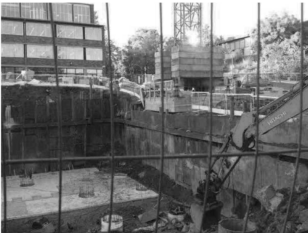
Fig. 4. Här syns tydligt att spontväggen lutar kraftigt. Spontväggen till vänster i bilden lutar dock ännu mer. I bilden kan man se stora marksättningar under kranfundamentet.
