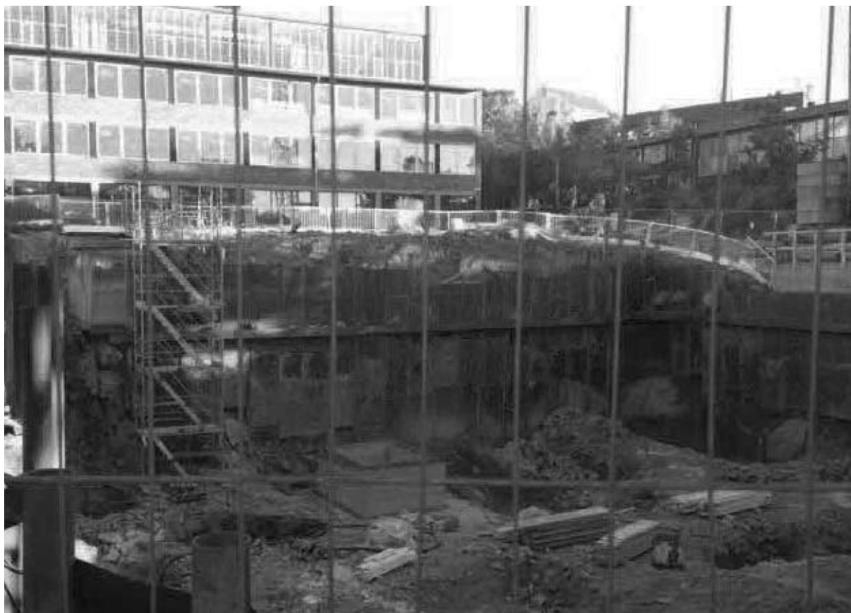
Fig. 3. Foto taget från den norra sidan av schakten. Till vänster i bilden har man sprängt ut berg och här syns nu att ett antal av rören i sponten hänger fritt i luften. Hammarbandet är inte kontinuerligt utan man kan tydligt se skarvar. Man har inte heller täckt väggen med plåtar utan det finns allt för stora hål där jord och stenar kan rasa ner över arbetande personal. Nu kan man se att schaktväggen börjar luta in mot schakten.
