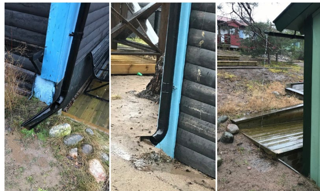
Figur 3.1.3. På Sandön är husens tak försedda med stuprännor, men regnvattnet rinner direkt ut på marken. (Foto: Privat)
